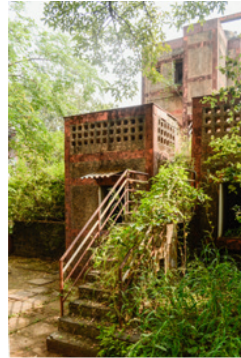
Een verlaten woning in cluster A2 An abandoned dwelling in cluster A2
